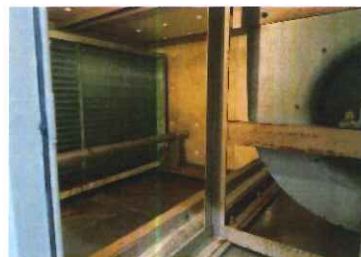
【空調設備(送風機)】
